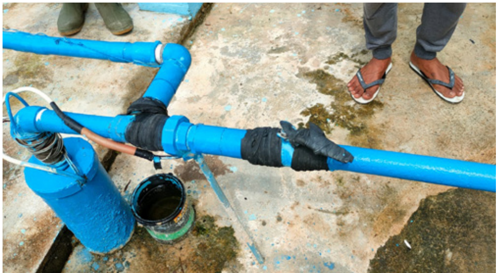
Gambar 2: Perbaikan kecil pada pipa untuk sistem sumber air tanah di Dumai, Riau
