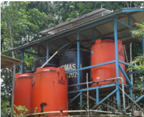
Gambar 5: Tangki penyimpanan air untuk sistem air permukaan di Sintang, Kalimantan
