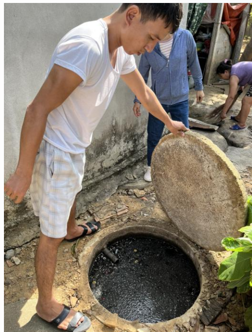
Khó mở nắp bể
